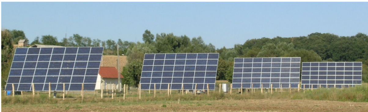
6. ábra: Fekeden a vízmű villamosenergia-felhasználását fedezik napelemekkel
