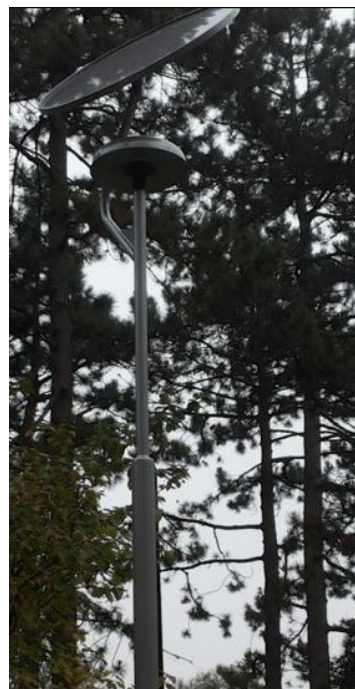
4. ábra: Margit-szigeti napelemes LED közvilágítás
