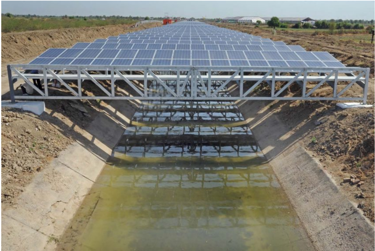
28. ábra: Napelemes rendszer csatorna fölött kialakítva 55
